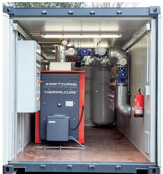
Für das aktuelle Projekt Albvorlandtunnel liefert Kraft das beschleunigte Betonhärtungssystem Thermalcure®, wobei das Herzstück (Heißwasserkessel) der Anlage in einem isolierten, belüfteten und beheiztem Container verbaut ist.
