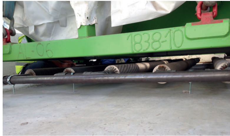
Unter den Tübbingschalungen befinden sich Hochleistungsrippenrohre, die 600 Watt je Meter Strahlungswärme erzeugen und so bei Bedarf die Schalungen kontrolliert bis auf 60°C erwärmen.
